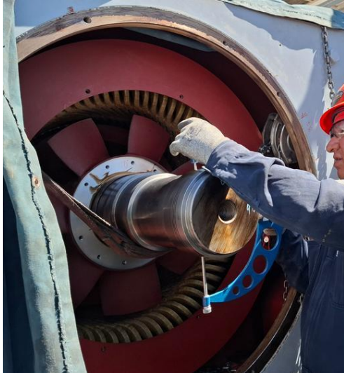
Fotografía del informe técnico del motor TMEIC de 7,000 HP, mayo de 2025.
